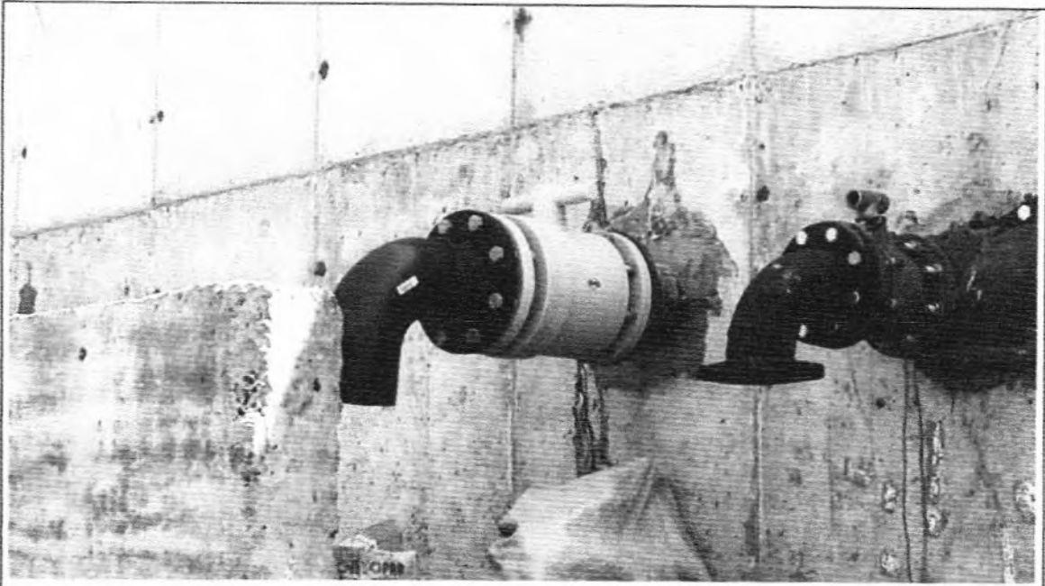
Descrição: Instalação do registro do coletor de espuma do Reator 1.
