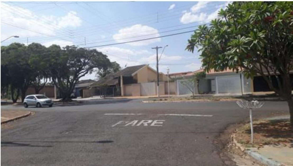
6. Localização: cruzamento da Adolfo Viesi com Avenida Mario da Silva Camargo Cenário: Placas de sinalização vertical de regulamentação R-1 (parada obrigatória) e R-24a (sentido de circulação na via) inexistentes
