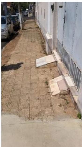
11.Localização: Rua Rui Barbosa entre as ruas Prudente de Moraes e Treze de Maio Cenário: Passeio público com largura reduzida (menor que a exigida) devido à presença de rampas de garagem
