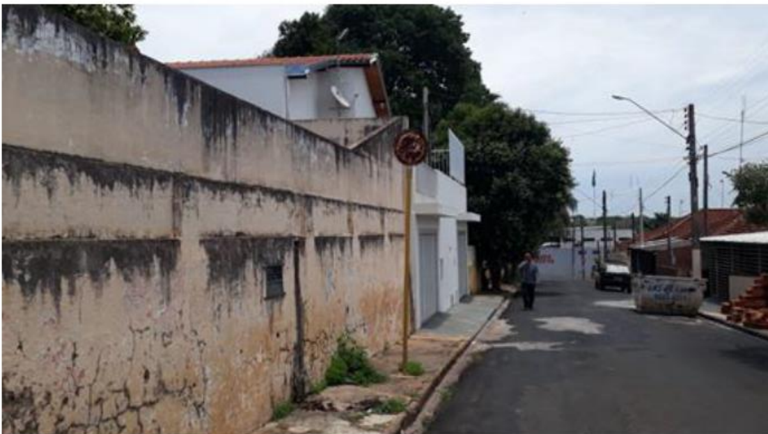
10. Localização: Rua Paschoal Mariano Cenário: Placa de sinalização vertical de regulamentação R-6 completamente avariada, sem condições de cumprir sua função
