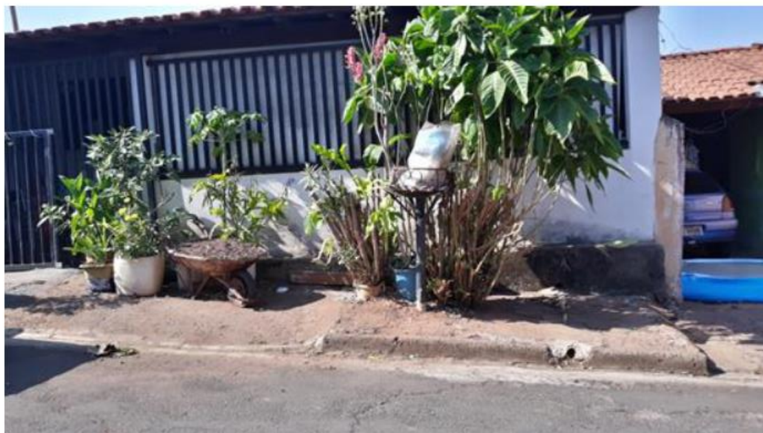
12.Localização: Rua Antônio D' Ambrósio entre as ruas Adamo Lui e José D' Ângelo Cenário: Passeio público obstruído
