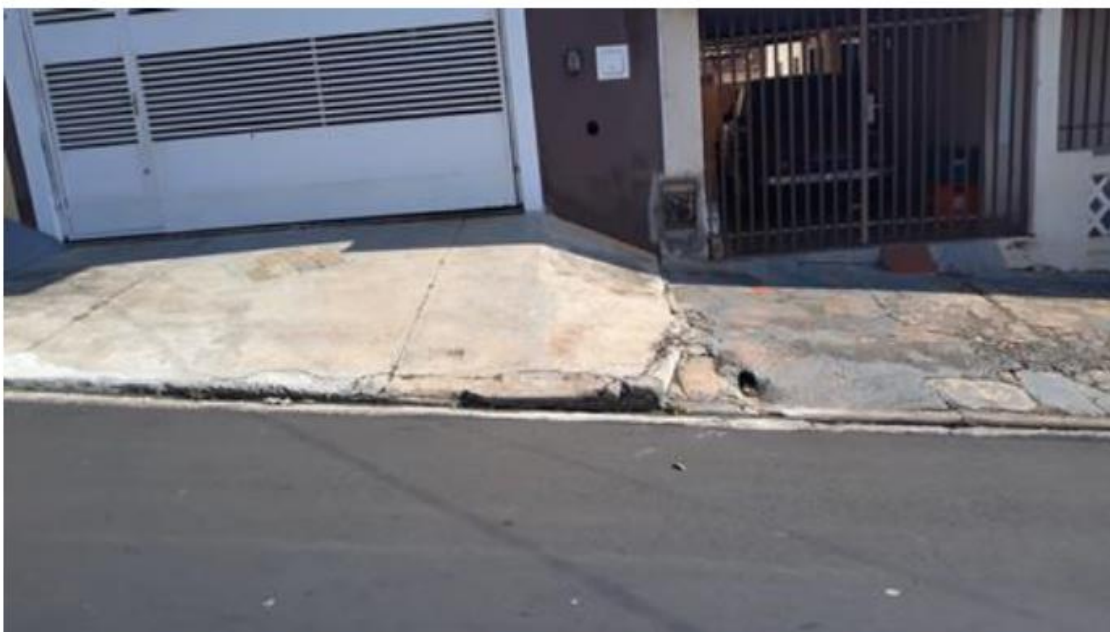
10.Localização: Rua General Glicério entre as ruas Domingues e Bernardino Sampaio Cenário: Passeio público com rampas longitudinais de inclinação maior que a permitida em norma
