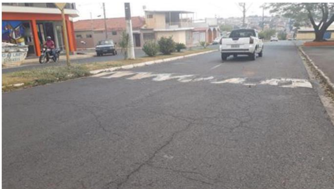
5. Localização: Avenida João Perissinotti em frente ao Ginásio de Esportes Antônio D' Ambrósio Cenário: Pintura de lombada em desacordo com o padrão exigido
