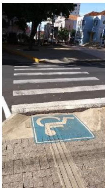
8. Localização: Cruzamento da Rua General Glicério com Rua Rui Barbosa Cenário: Rampa de acesso em desacordo com o padrão estabelecido pela NBR 9050
